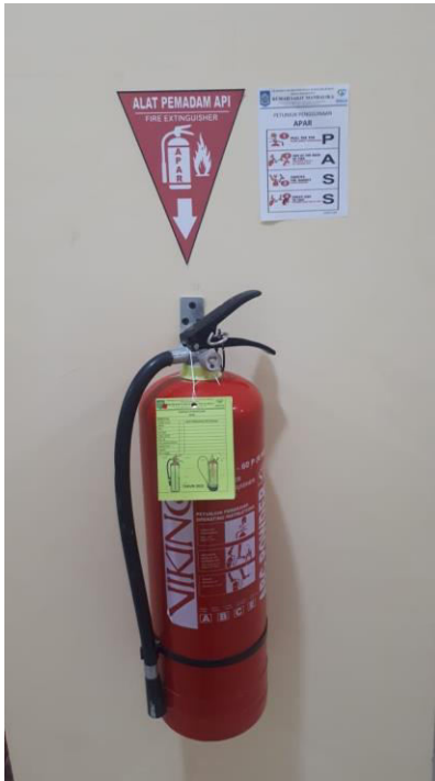
Gambar 3. Pemasangan SOP dan Kartu Kontrol APAR
